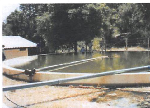
タイ 緩速ろ過の浄水場
